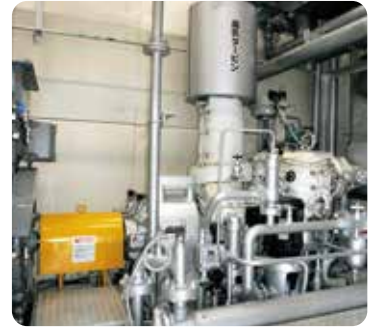
蒸気タービン発電機
