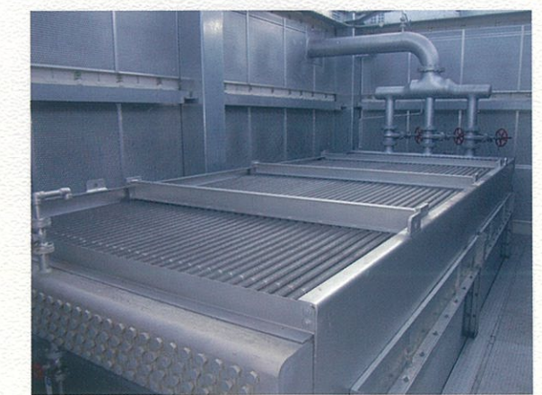
蒸気復水器 発電等に利用した蒸気を冷却し、水(復水)に戻します。
