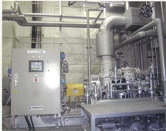
蒸気タービン・発電機 ボイラで発生した蒸気を利用し発電を行います。
