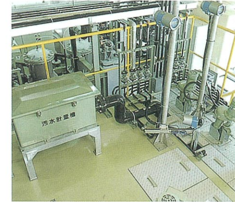
●カルシウム除去設備
