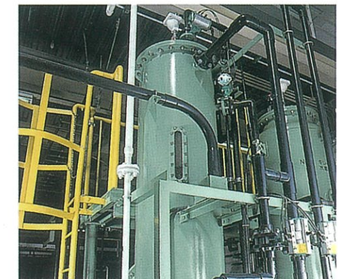
●活性炭吸着塔
