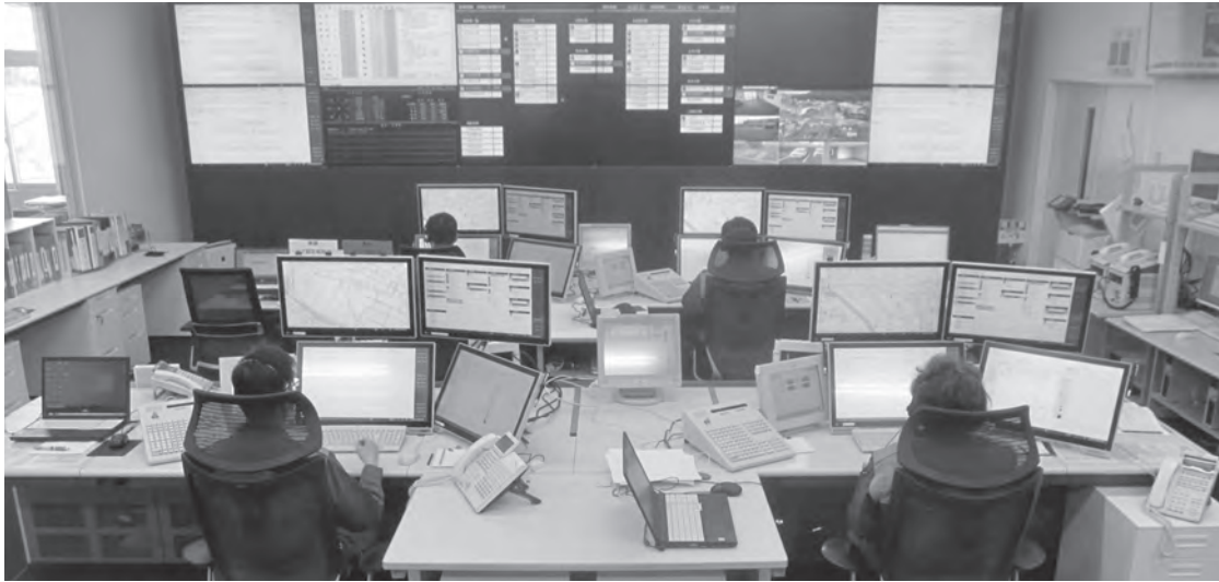
中間更新後の指令室内の様子
